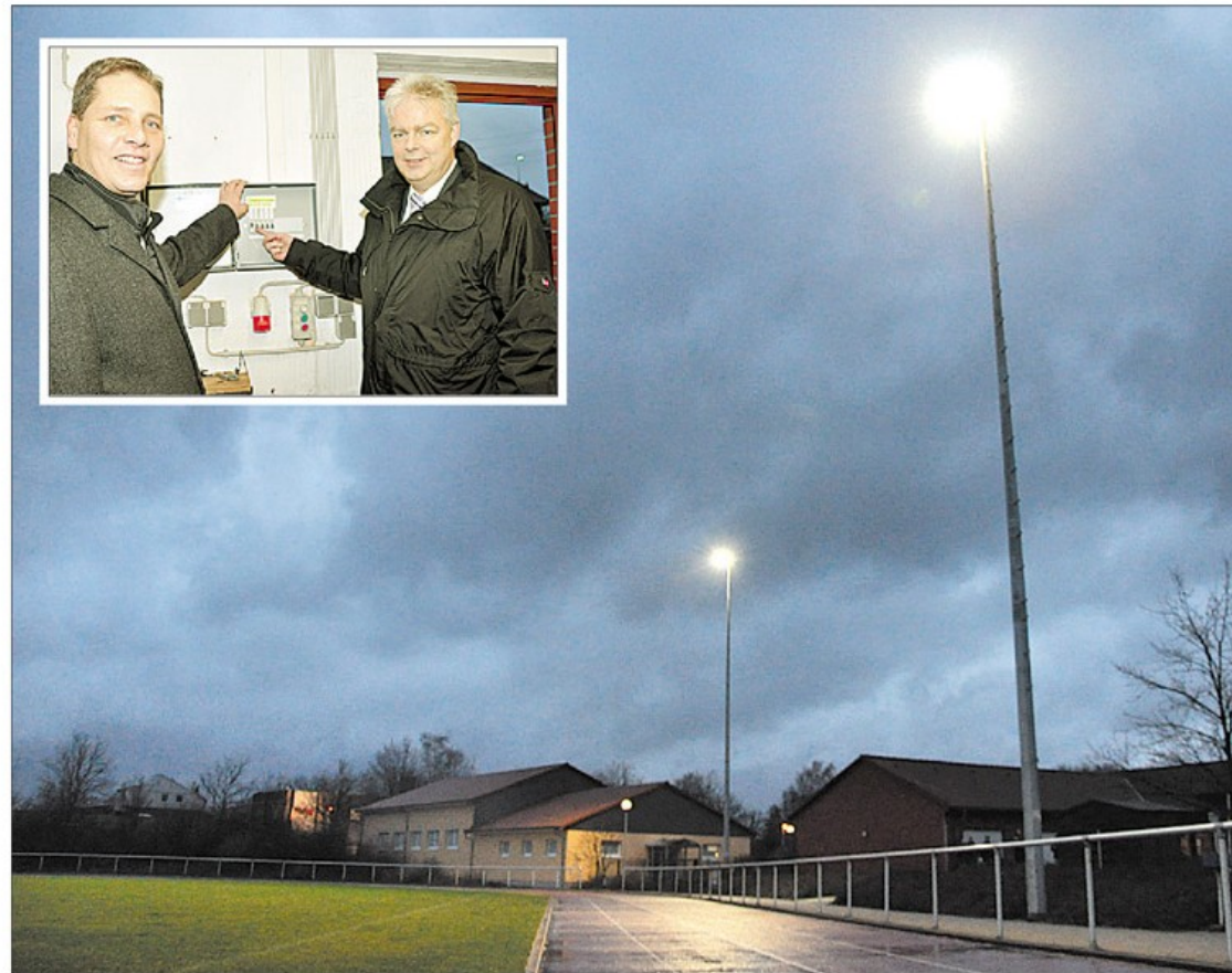
Die neue Flutlichtanlage der TSG Ahlten (großes Bild) beleuchtet den A-Platz. Stefan Hebel (kleines Bild, links) und Klaus Sidortschuk nehmen die Anlage in Betrieb und legen dafür den Hebel am Schaltkasten um. Eggers (2)
